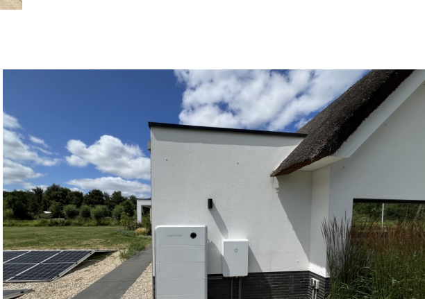
SigEnergy thuisbatterij 32kWh met Back-Up systeem
